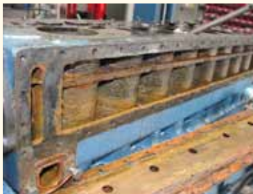
Packard Achtzylinder mit Wasserschaden vor der Restaurierung.
